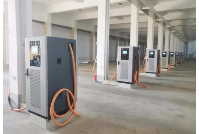
东丰县公交公司充电站
