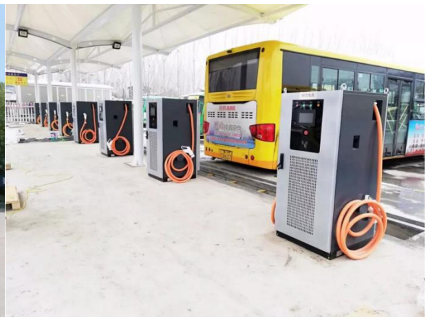
山东聊城公交充电站
