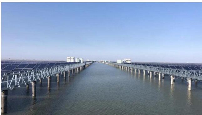
宁波慈溪周巷水库 200MW 渔光互补光伏发电项目
