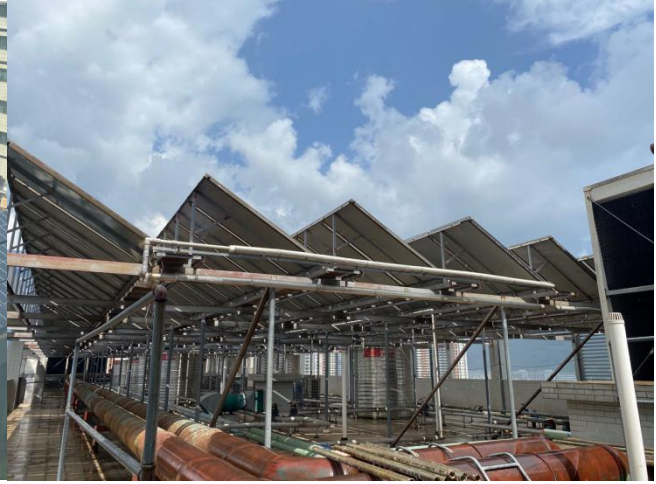
宿舍楼顶太阳能光伏板
